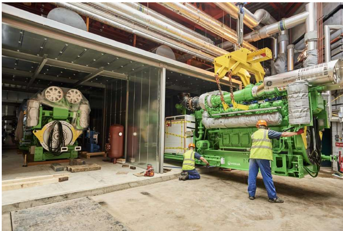
Figure 3 Nouvelles unités de cogénération installées à l'UEA
